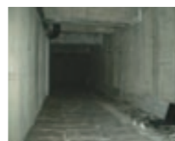
地中ピット内
