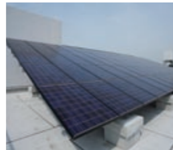
太陽光発電システム(大阪支店)
