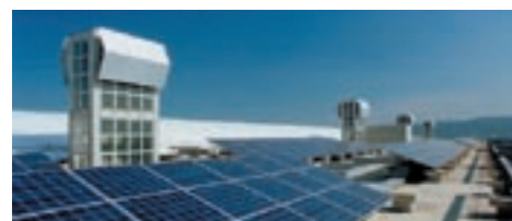
ソーラーチムニーと太陽光発電パネル
