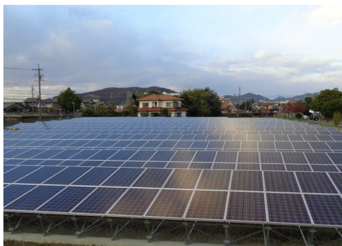
太陽光発電設備
